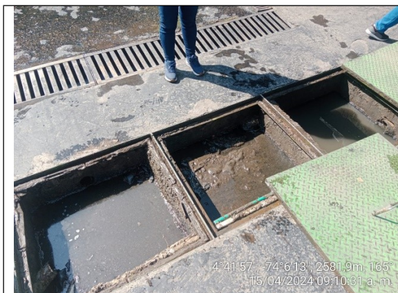
Foto No.5. Trampa de grasas
