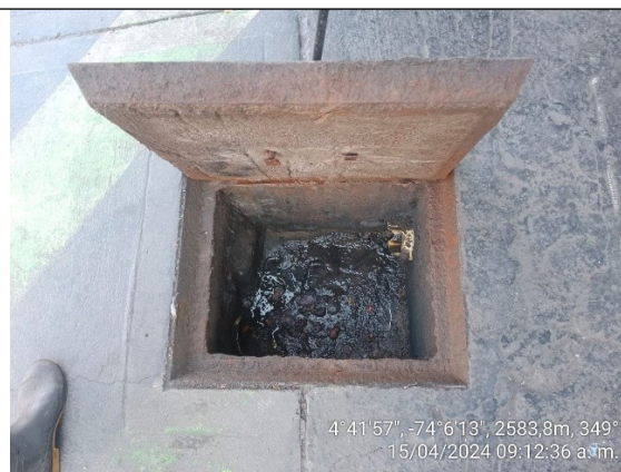
Foto No.6. Caja de Inspección Externa
